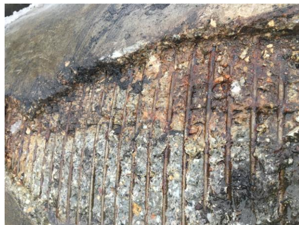
Bilde viser ødelagt rør rett oppstrøm kraftstasjonen, der vi må bytte til nye rør.
