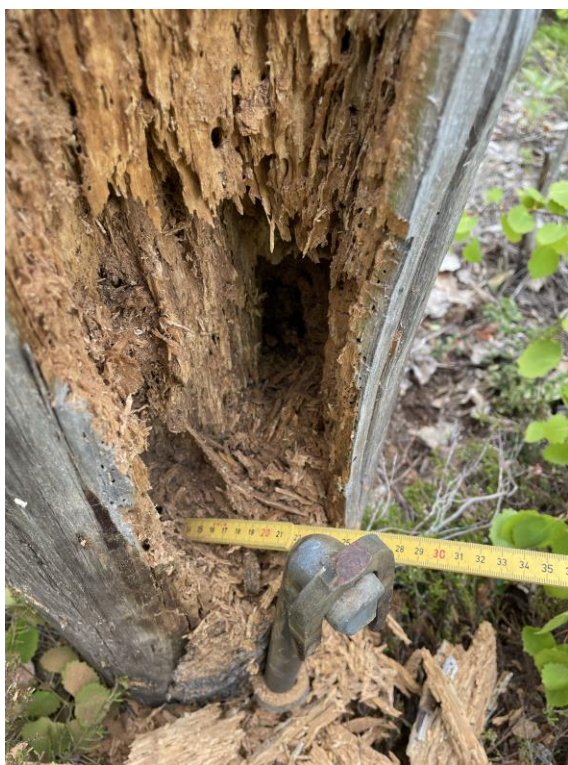
Råte i stolpe oppdaget under årskontroll av høyspentlinjene.
